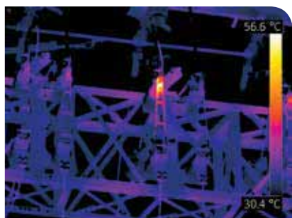
Überhitzender Trennschalter in einem Umspannwerk
