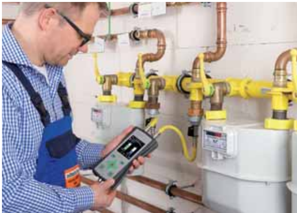
Leckmengenmessung bei demontiertem Zähler
